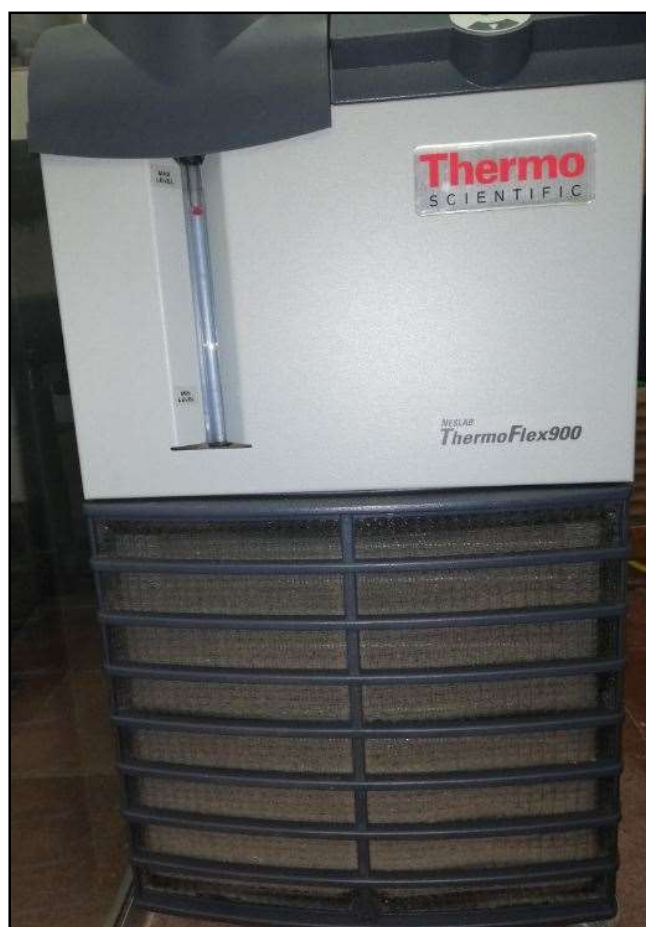
Imagen 1. Enfriador de agua.
